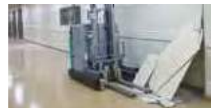
製造エリア 機械室からの水漏れ、壁と天井部のひずみ、壁の破損など
