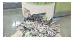
管理事務棟 水漏れ、天井の崩落、柱壁の破損など
