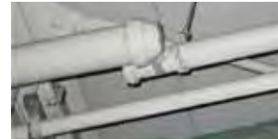
機械室 配管の破損、吊り金具の破損・脱落など
