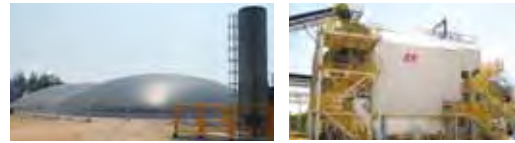
カンベンペット工場のバイオガス回収設備
