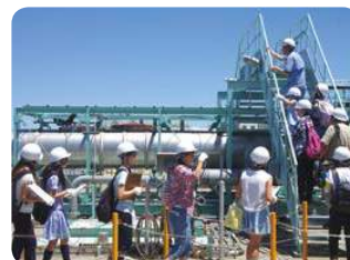
排水処理設備
