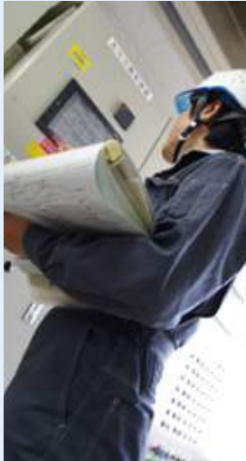
(左) 計器の動作確認
