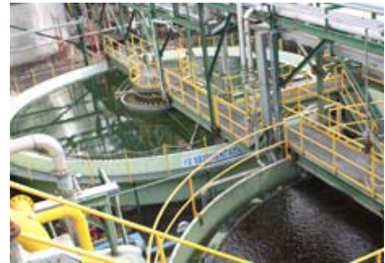
ベトナム味の素社のBDNおよび凝集沈殿設備
